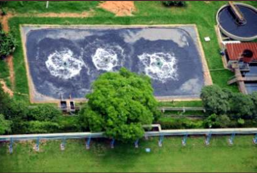
Estação de tratamento de esgoto em área industrial, Nova Odessa, SP. | Foto: Fábio Torresan.
