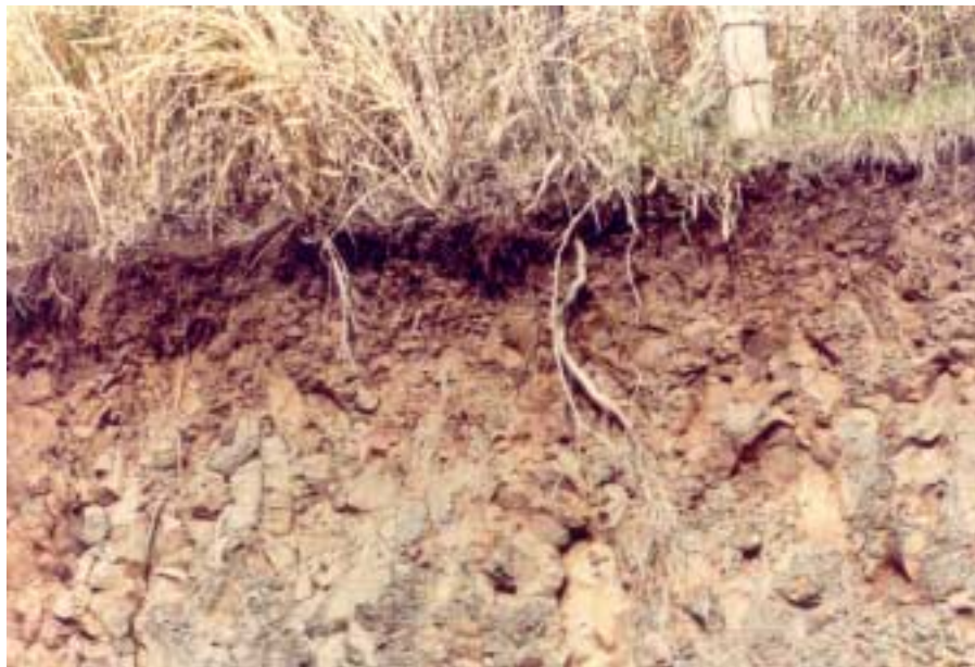
FIGURA 61. Aspecto do fendilhamento no substrato rochoso (Re1).
