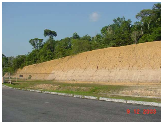
Figura 4. Talude de corte desprovido de vegetação apresentando erosão em sulcos e ravinas em talude do Aeroporto de Manaus.
