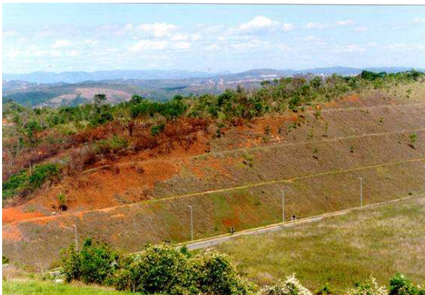
Figura 3. Problemas de erosão em taludes de corte do Aeroporto Internacional de Confins MG.
