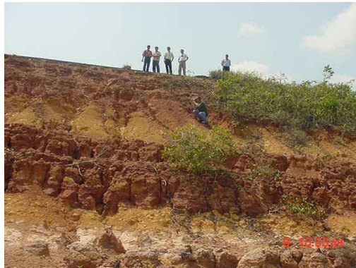
Figura 5. Taludes de corte próximo à pista de taxiamento do aeroporto de Manaus, apresentando forte processo de erosão laminar, em sulcos e ravinamentos.
