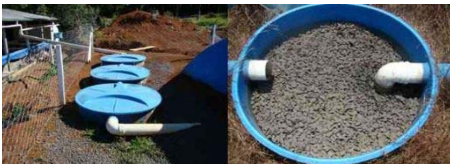
Figura- Sistema de filtragem da água de chuva captada.
