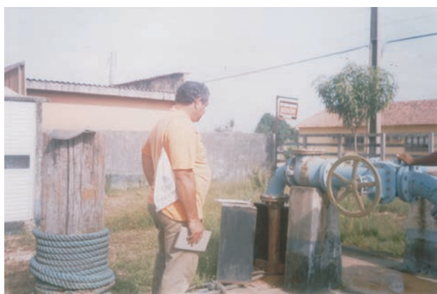
Figura 7. Captação subterrânea através de poço tubular.
