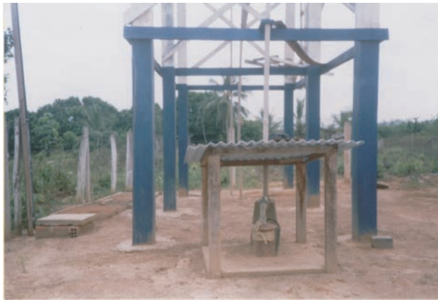
Figura 9. Sistema de captação d’água subterrânea na agrovila Alvorada.
