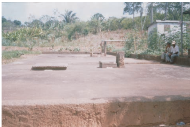
Figura 3. Cisterna para armazenamento de água do aquífero aluvionar, em Brasil Novo.
