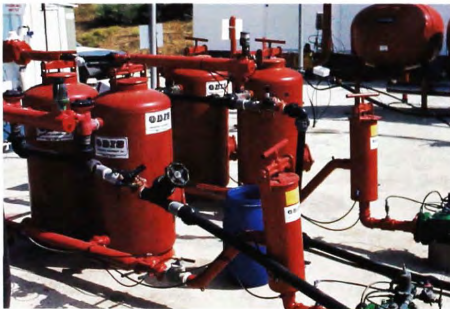
FIG. 9. Conjuntos de filtros de areia e tela para filtragem da água de irrigação.
