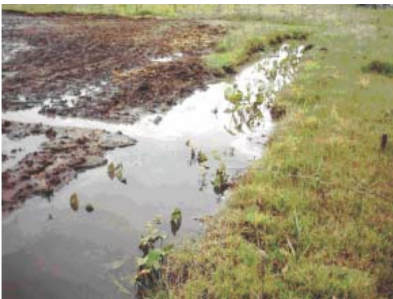
Figura 18. Dreno coletor externo da lavoura sem manutenção de limpeza. Embrapa Clima Temperado, 2004.
