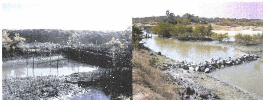
Fig. 5. Preparação da área na fazenda de camarão para o cultivo de ostras. (A) Represamento para a manutenção do nível da água no canal de drenagem. (B) Barragem para a diminuição da correnteza da água da drenagem.
