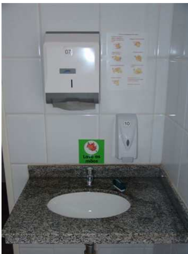
Fig. 2. Lavabos para adequada higienização das mãos.
