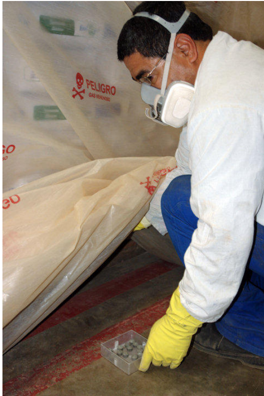
Figura 20. Aplicação de comprimidos ou pastilhas de fosfina nos cantos abertos da lona plástica.
