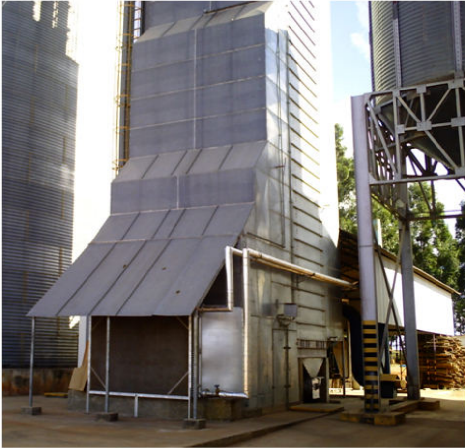
Figura 4. Caldeira acoplada ao secador para aquecimento do ar de secagem.
