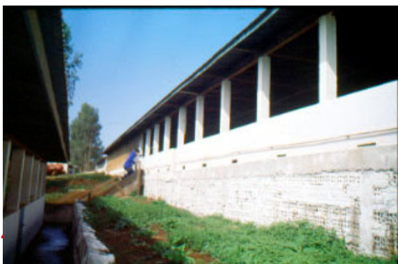
Figura 9 – Erro freqüente de construção dos canais externos e de beirais curtos, contribuindo para mistura da água da chuva captada pelo telhado com os dejetos nas canaletas.
