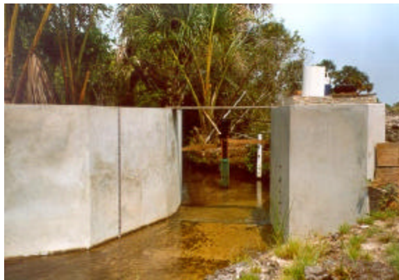
Fig. 3. Vista da calha Parshall no Córrego Água Limpa, em Alcinópolis, MS.
