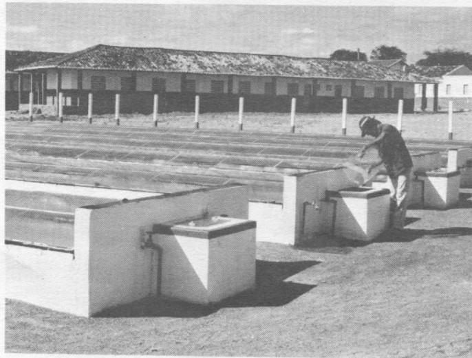
O sistema é suficiente para abastecer a escola
