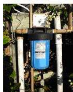
Fig 8: Filtro auxiliar instalado na entrada da caixa d'água reciclada
