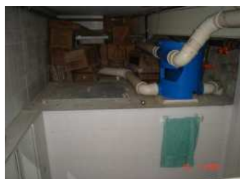
Fig 5: cisterna de águas pluviais de 4m 3 , com o filtro 3P
