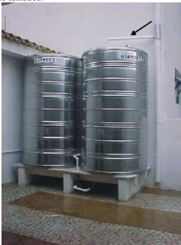
Figura 4- Reservatórios de aço inox apoiados
