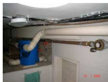
Fig 6: hidrômetro na tubulação de recalque de água pluvial
