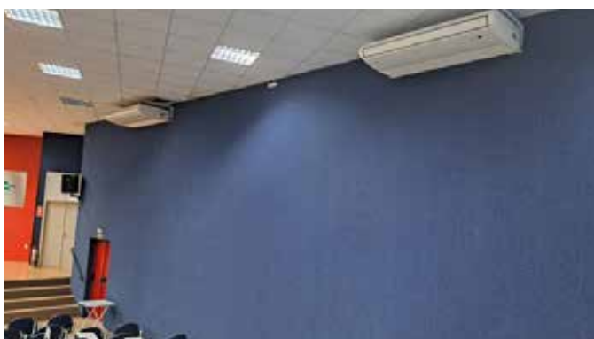
Aquisição de aparelhos de ar-condicionado para o auditório da Unidade.
