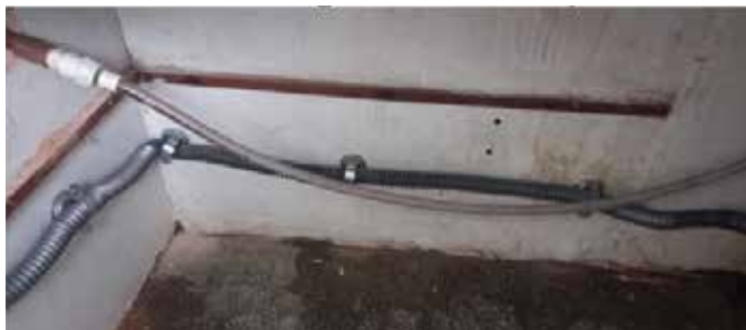
Revisão hidráulica do dreno da máquina de gelo, lavagem e esterilização.
