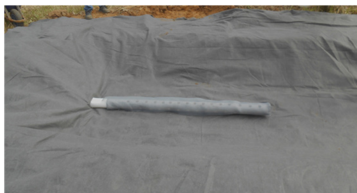
Figura 21: Foto com destaque do tubo para drenagem (saída do esgoto tratado), perfurado e com tela de mosquito para maior proteção. Autor: Carlos Renato Marmo.
