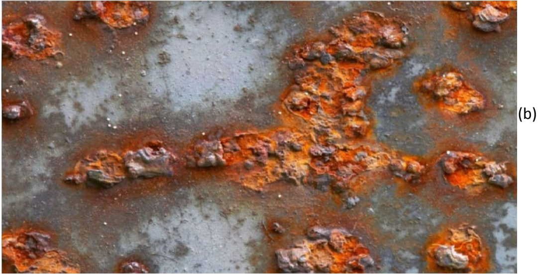
Figura 7 – Corrosão causada por incrustação.
