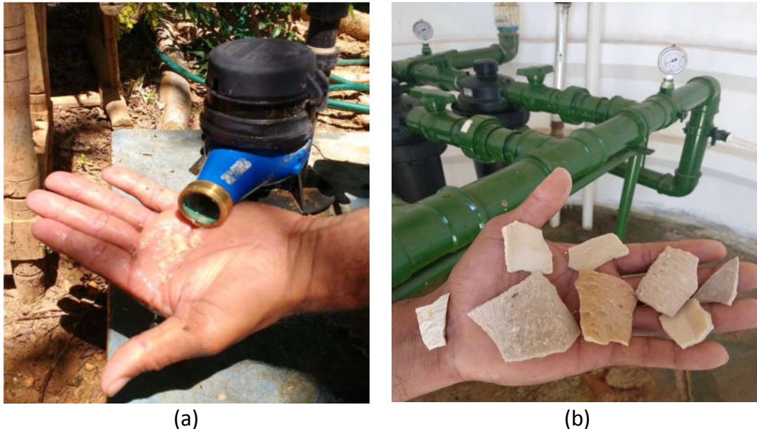
Figura 18 – Fatos ocorridos no SAA devido ao teor elevado de dureza da água. (a) Hidrômetro entupido; (b) Material encontrado dentro das tubulações e reservatório elevado.
