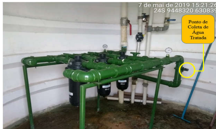
Figura 22 – Ponto de coleta de água tratada
