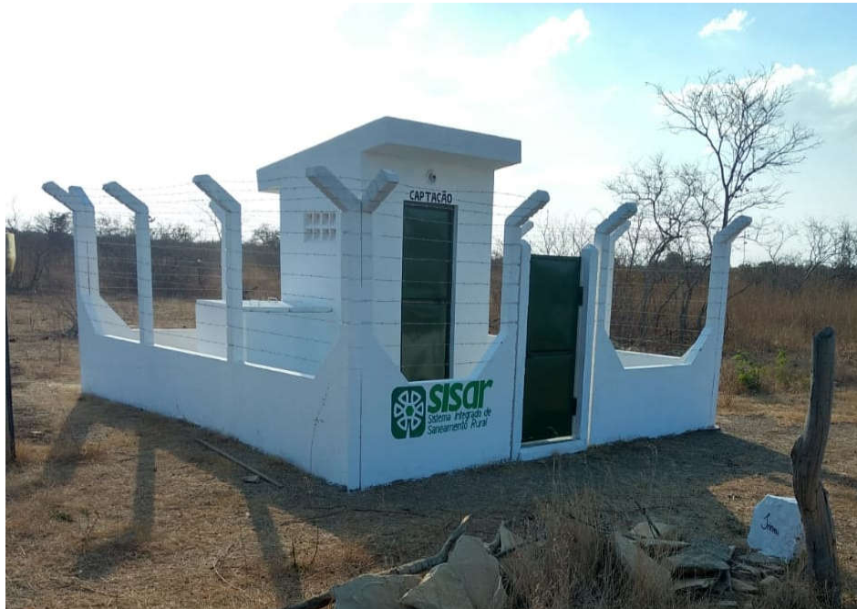
Figura 20 – Área da captação do poço tubular na localidade de Serra dos Vieiras, município de Russas (CE)
