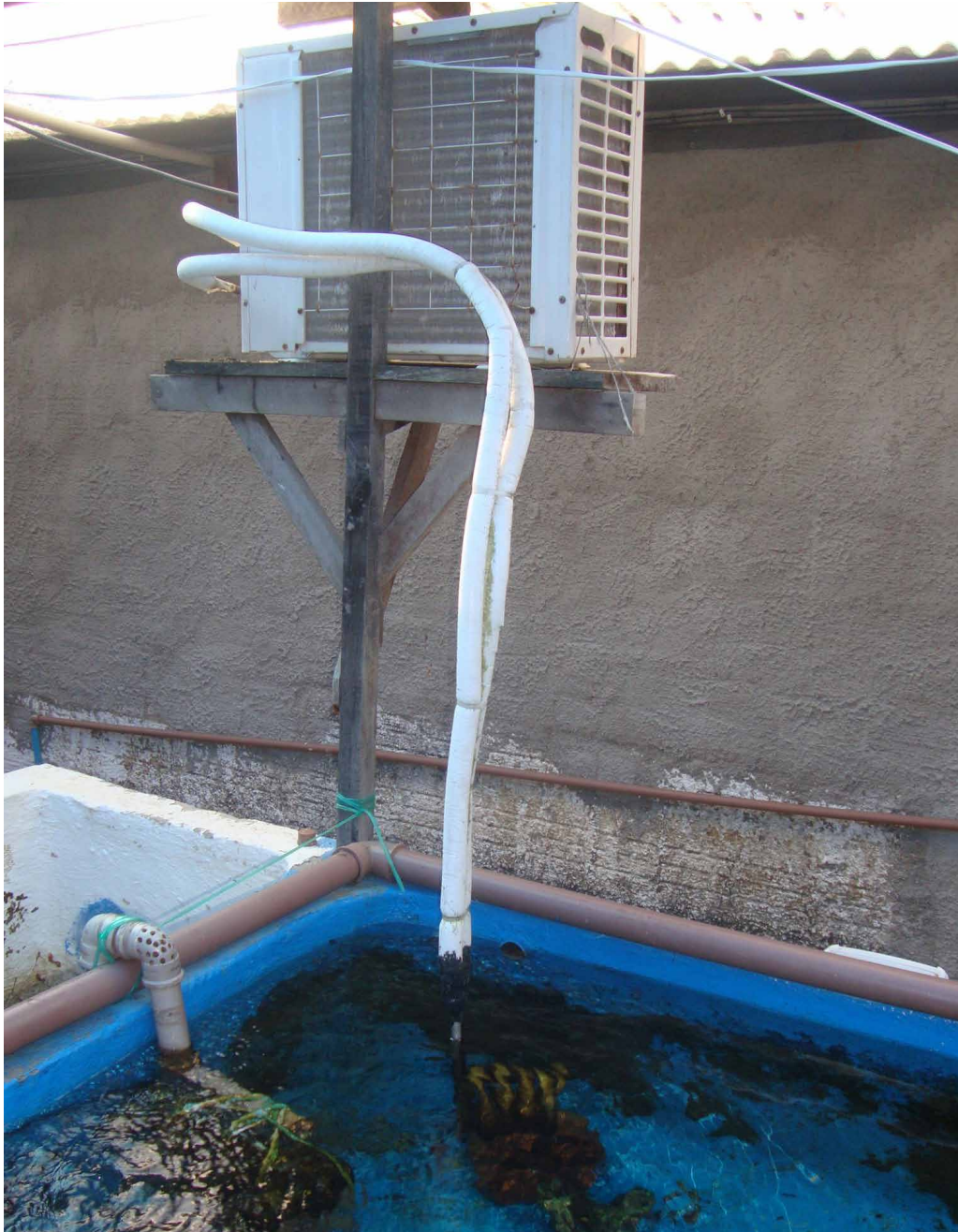
Figura 67. Adaptação de aparelho de ar condicionado com central eletrônica de controle de temperatura regulado por sonda aquática, para monitoramento da temperatura da água em tempo real.
