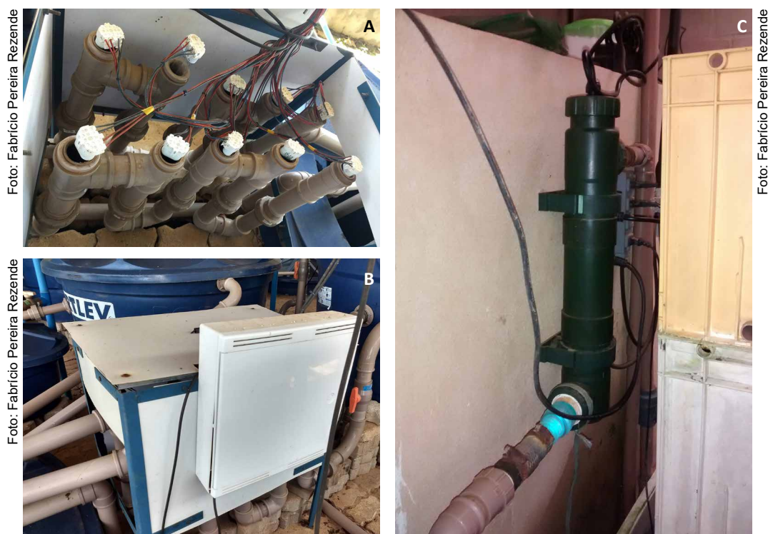
Figura 63. Vista panorâmica das tubulações hidráulicas (A) de um filtro germicida de irradiação ultravioleta multilâmpada em RAS de grande volume (B); filtro ultravioleta monolâmpada aco-plado em sistema de filtragem (C).
