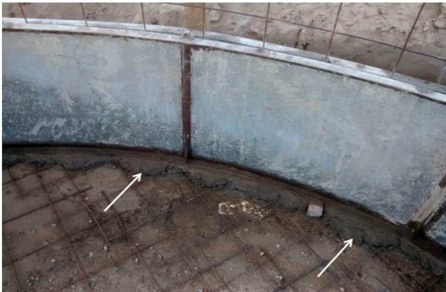
Figura 28. Massa de concreto extravasando pela base da forma interna.
