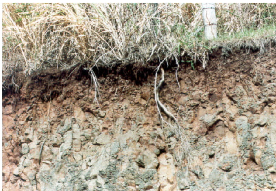
FIGURA 61. Aspecto do fendilhamento no substrato rochoso (Re1).
