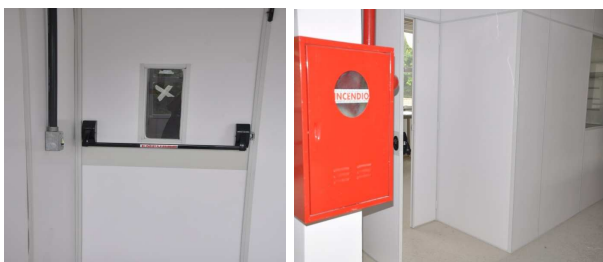
Figura 47. Portas corta-fogo instaladas em cada sala dos laboratórios e Mangueiras e hidrante em cada andar.
