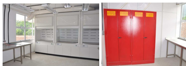
Figuras 45 e 46. Instalações das capelas, bancadas e armários apropriados para uso com solventes.
