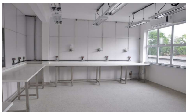
Figura 44. Instalações internas, destacando luminárias refletivas com sistema econômico de energia.
