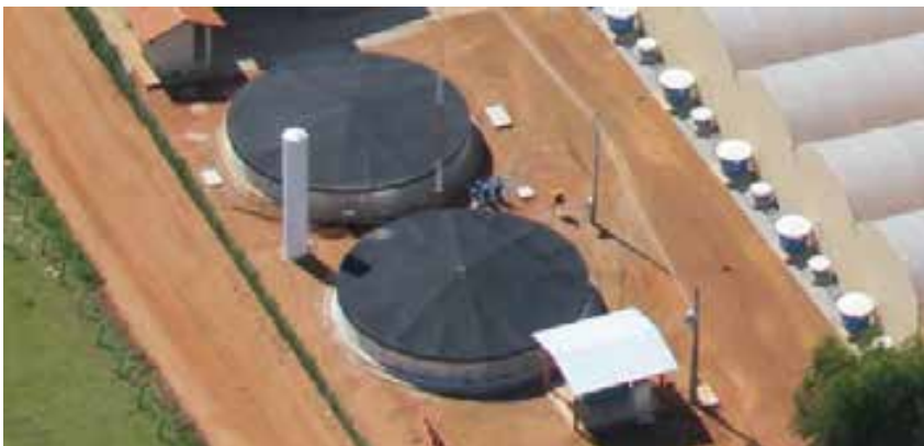
Figura 21. Vista aérea dos reservatórios australianos: capacidade de 250 mil litros cada.
