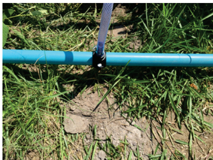
Figura 19. Detalhe da estrutura de derivação de água da linha adutora/principal para a entrada no pulmão.
