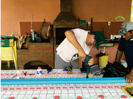
Figura 10. Furação da tubulação adutora/principal para fixação das conexões de derivação da água para entrada e saída do fluxo pela câmara interna do pulmão.
