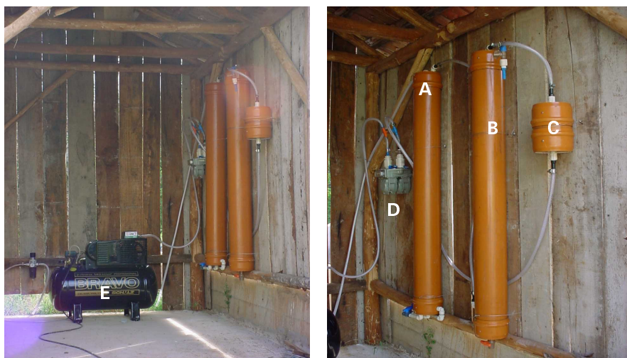
Fig. 2. Unidade para purificação e compressão do Biogás. A) Coletor de Umidade; B) Filtro de H_2S ; C) Espuma; D) Totalizador de gás; E) Compressor de gás
