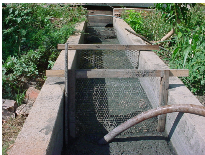
Fig. 4. Colocação de telas nas canaletas de dejetos
