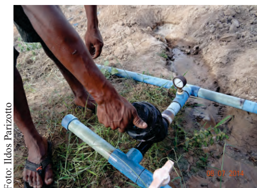
Figura 27. Filtro instalado no início de um sistema de irrigação.
