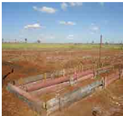
Canteiro pronto para recepção do composto e construído com material rústico (lascas de madeira não aparelhadas) e de parede interna dupla para otimização dos materiais utilizados.
