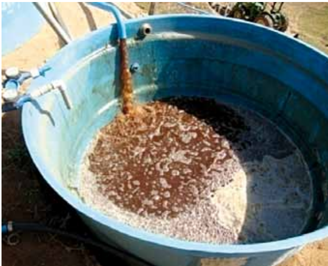
Figura 15. Caixa da água de reúso sem os filtros SLAR.
