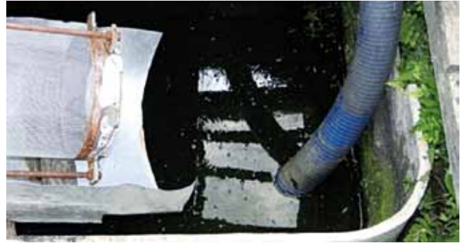
Figura 16. Bombeamento da caixa de decantação para reúso.
