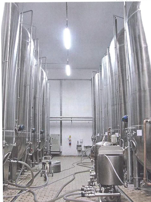
Figura 6: Ambiente ideal para a elaboração de vinhos e derivados, onde o piso é impermeável, antiderrapante e de fácil higienização, as luminárias possuem proteção, a fiação elétrica está embutida e o teto possui forro e visivelmente não tem aberturas que facilitem a entrada de pragas e insetos.
