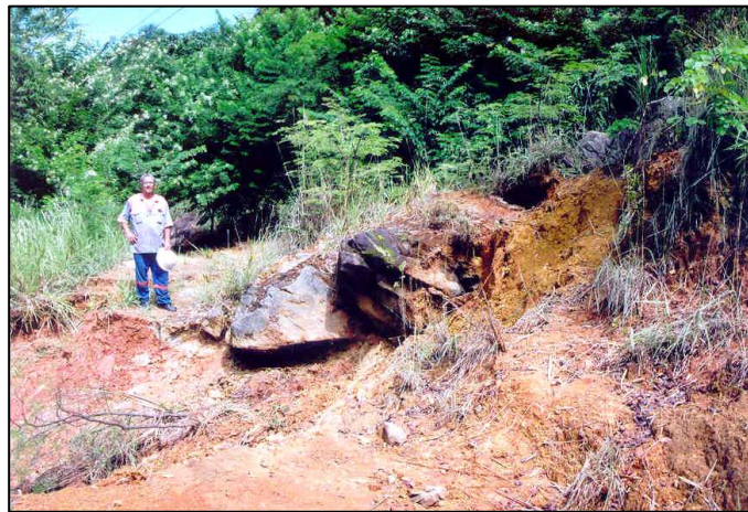
Fig. 6. Detalhe das rochas deslocadas com o arraste da terra no local onde ocorre o “escorregamento do solo” sobre o canal e próximo ao Rio Itabapoana
