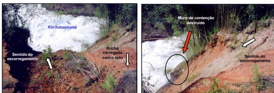
Fig. 9. Vista da área em que o Rio Itabapoana afeta o local onde ocorre o "escorregamento do solo". Junto ao Rio, detalhe do muro de concreto destruído pela força das águas (foto inferior).
