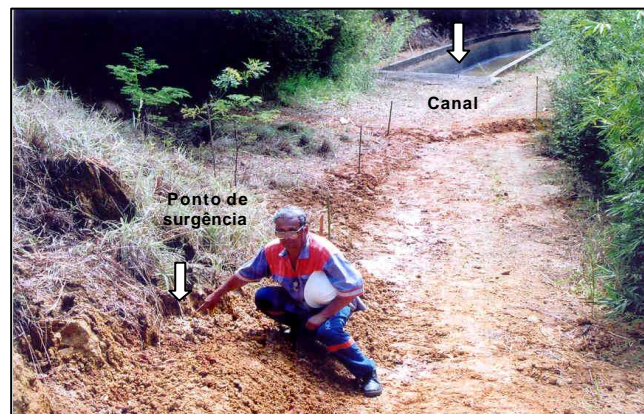
Fig. 4. Detalhe de um dos locais onde ocorre a surgência de mina d'água na área do "escorregamento do solo" sobre o canal
