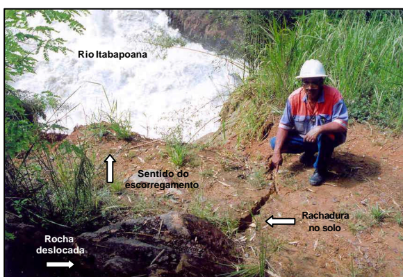
Fig. 10. Detalhe das rachaduras que ocorrem no local do escorregamento do solo próximo ao Rio.
