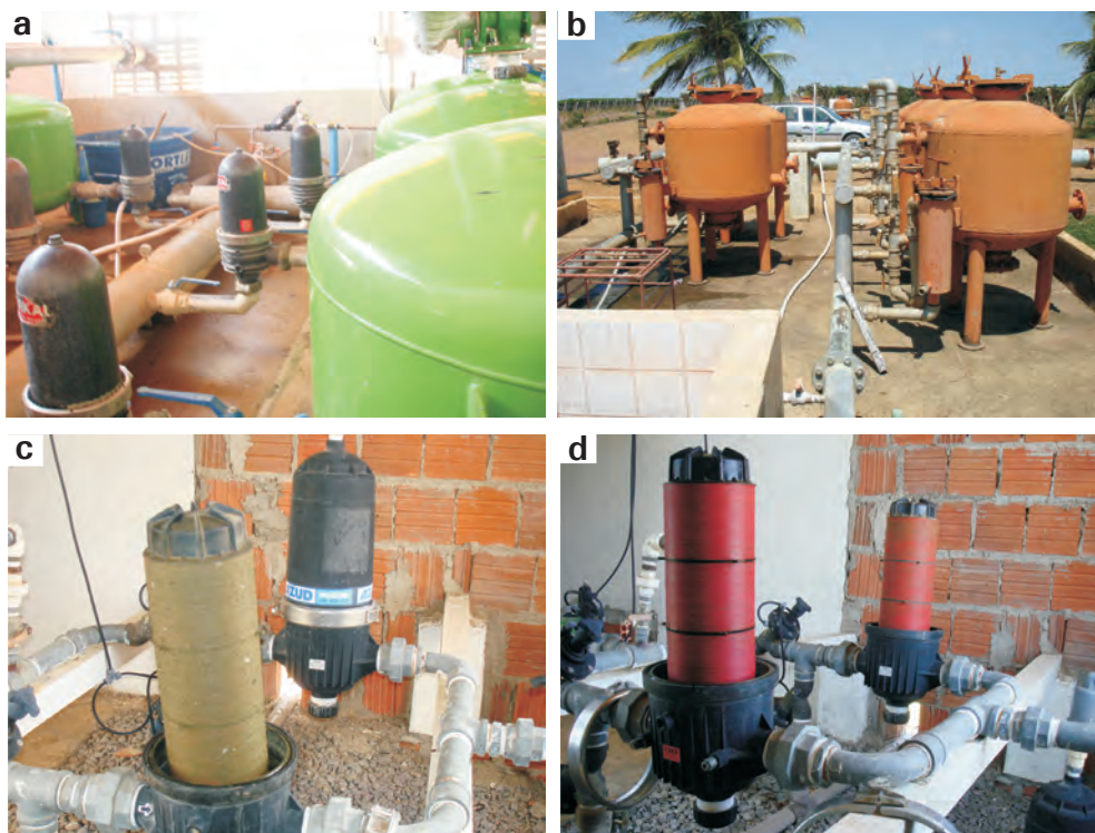
Figura 21. Cabeçal de controle com: a) filtro de areia e disco; b) filtro de areia e tela; c) filtro de disco sujo; d) filtro de disco limpo.
