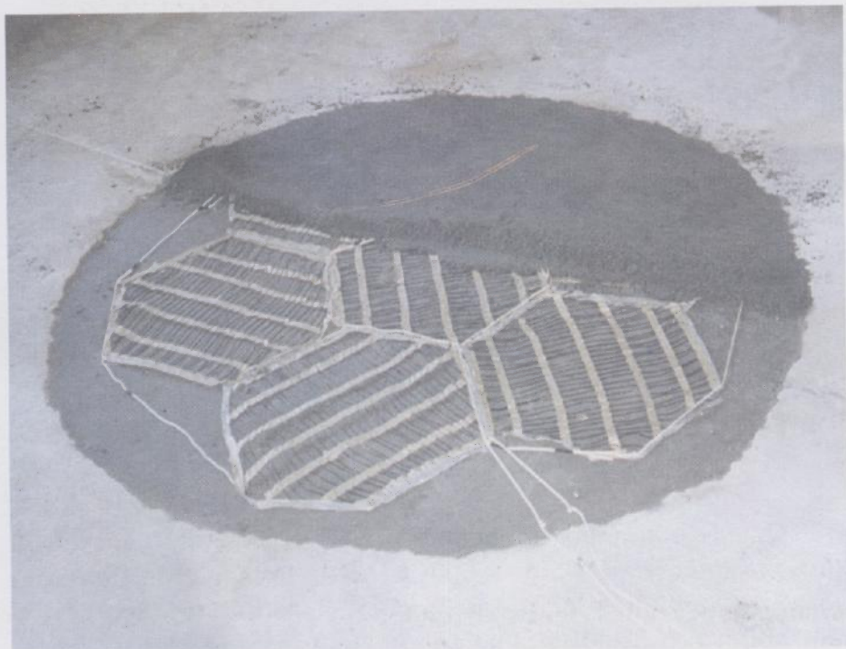
FOTO 3 - Esquema de distribuição das resistências, no sistema de aquecimento em piso com resistência elétrica embutida.
