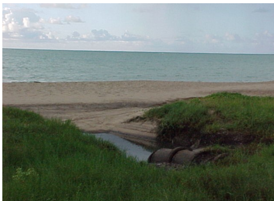
Figura 27. Detalhe de esgoto lançando dejetos diretamente na praia.
