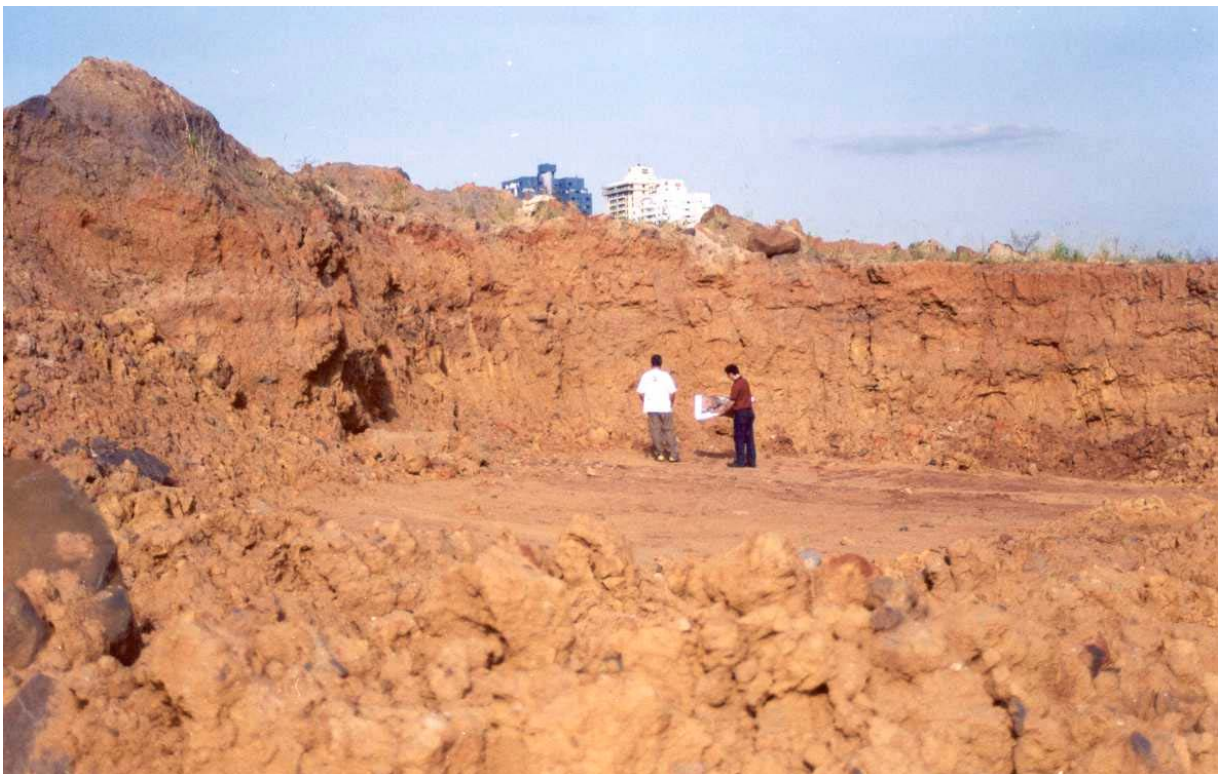
Fig. 3 – Trabalho de medição e monitoramento das camadas de material depositadas no bota-fora do Parque Dom Pedro Shopping S/A.
