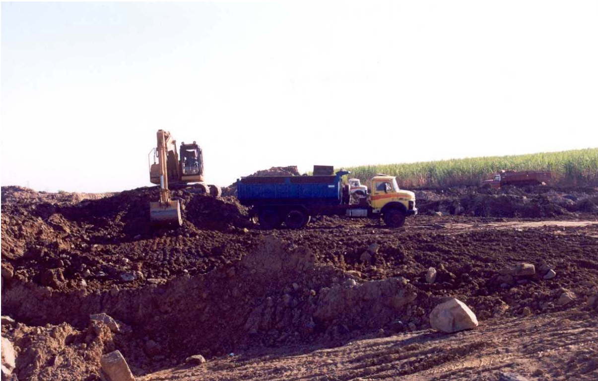
Fig. 4 – Início da remoção do bota-fora do Parque Dom Pedro Shopping S/A, no ano de 2002.
