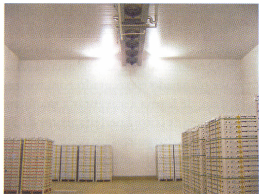
Fig. 22. Câmara de armazenamento refrigerado de uvas de mesa.
