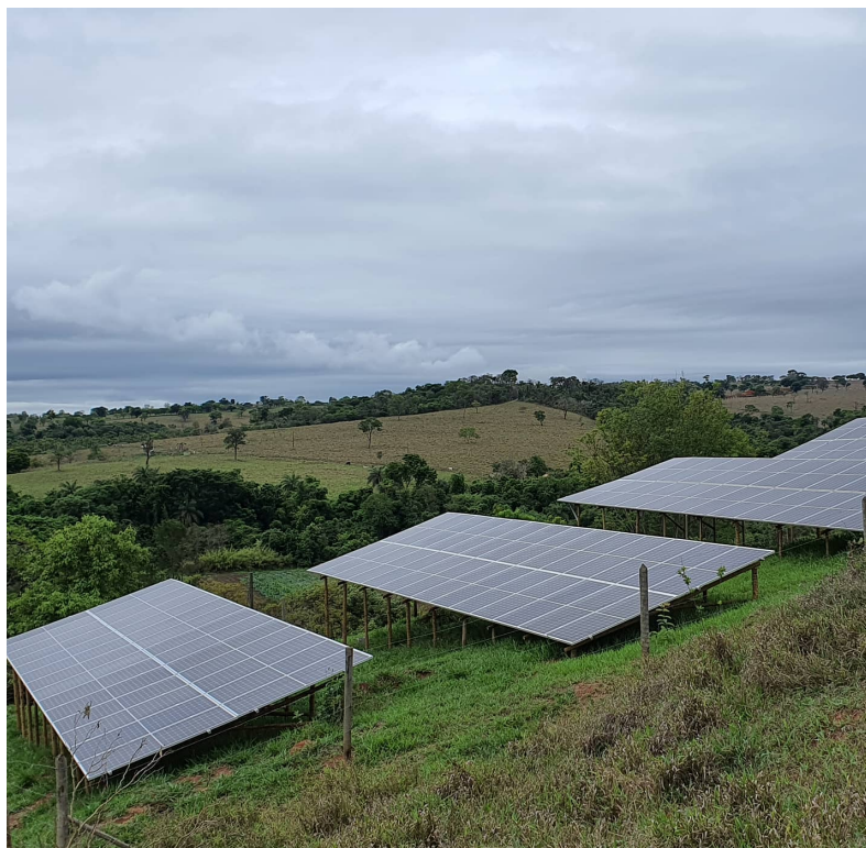
Figura 11. Sistema de produção de energia fotovoltaica.
