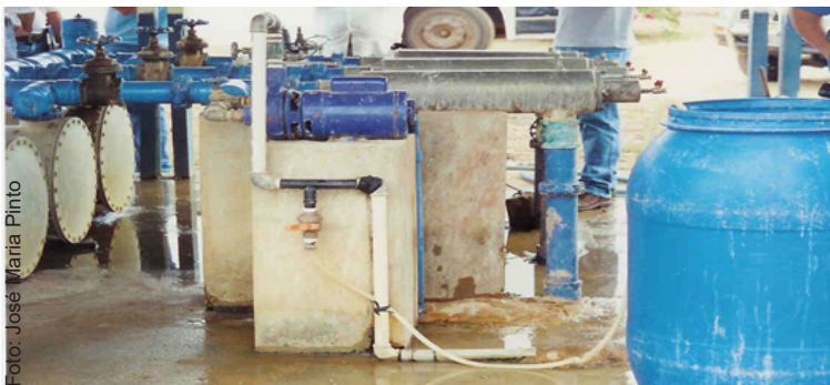
Figura 5. Detalhe de Venturi no cabeçal de controle.
