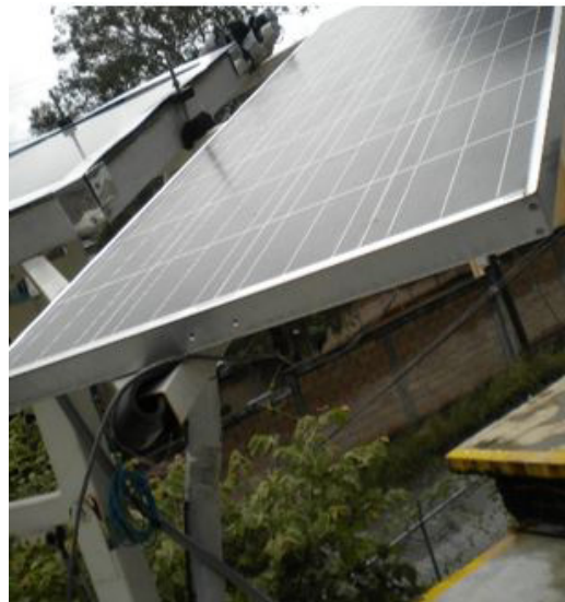
Figura 6 Panel solar Kyocera KC130TM localizado en el exterior para captar los rayos solares
