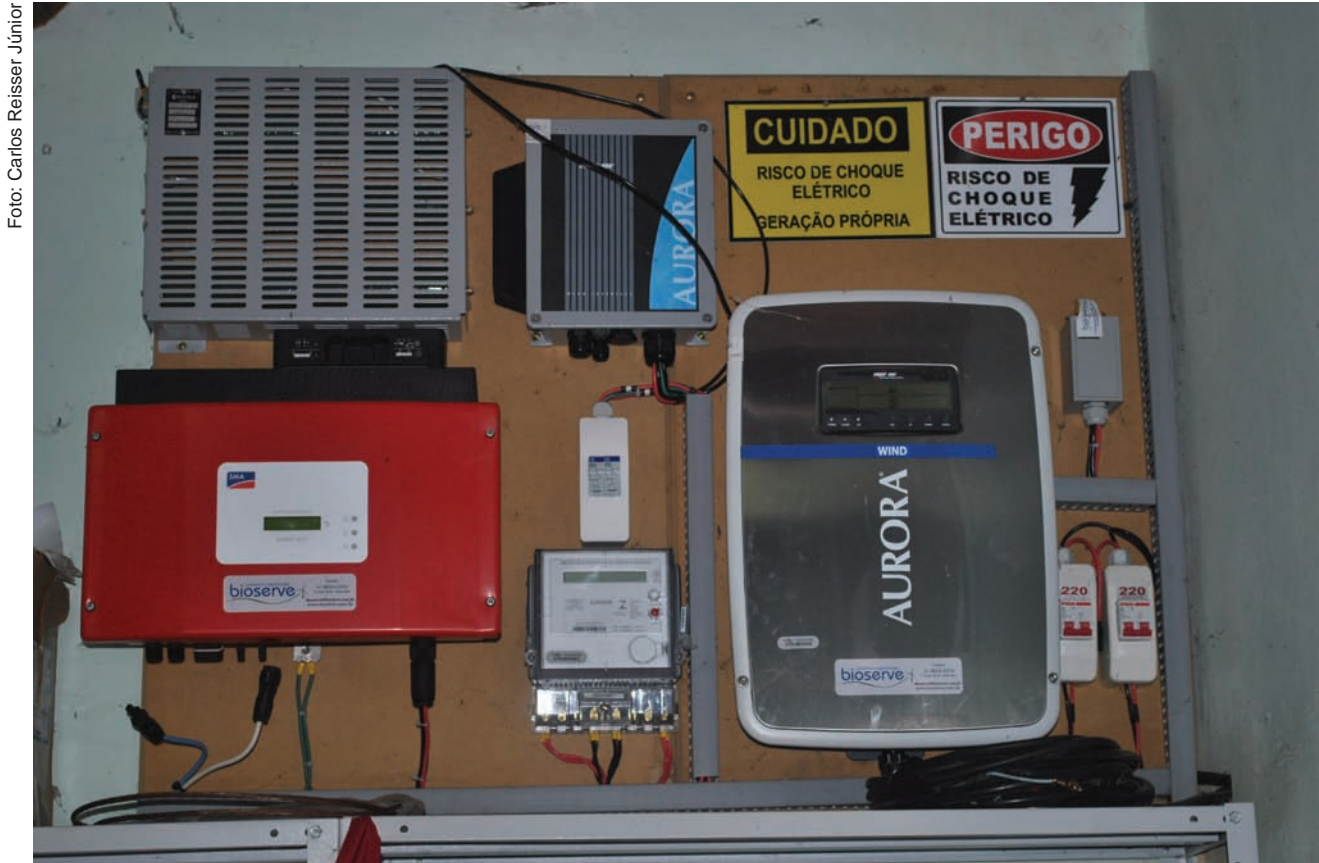
Figura 5. Painel elétrico dos sistemas de geração contendo dois inversores (eólico e fotovoltaico) e demais equipamentos de medida e segurança, utilizados no trabalho.
