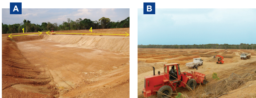
Figura 2. Proporção ideal entre largura e comprimento (1:4) dos viveiros (A); Máquinas trabalhando na construção de viveiros (B). Fotos: (A) Fabrício P. Rezende; (B) Giovani T. Bergamin.
