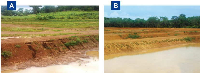
Figura 20. Talude de viveiros sem cobertura vegetal erodido pela chuva (A) e talude com plantio de grama-batatais em fase inicial de vegetação (B). Fotos: Fabrício P. Rezende.
