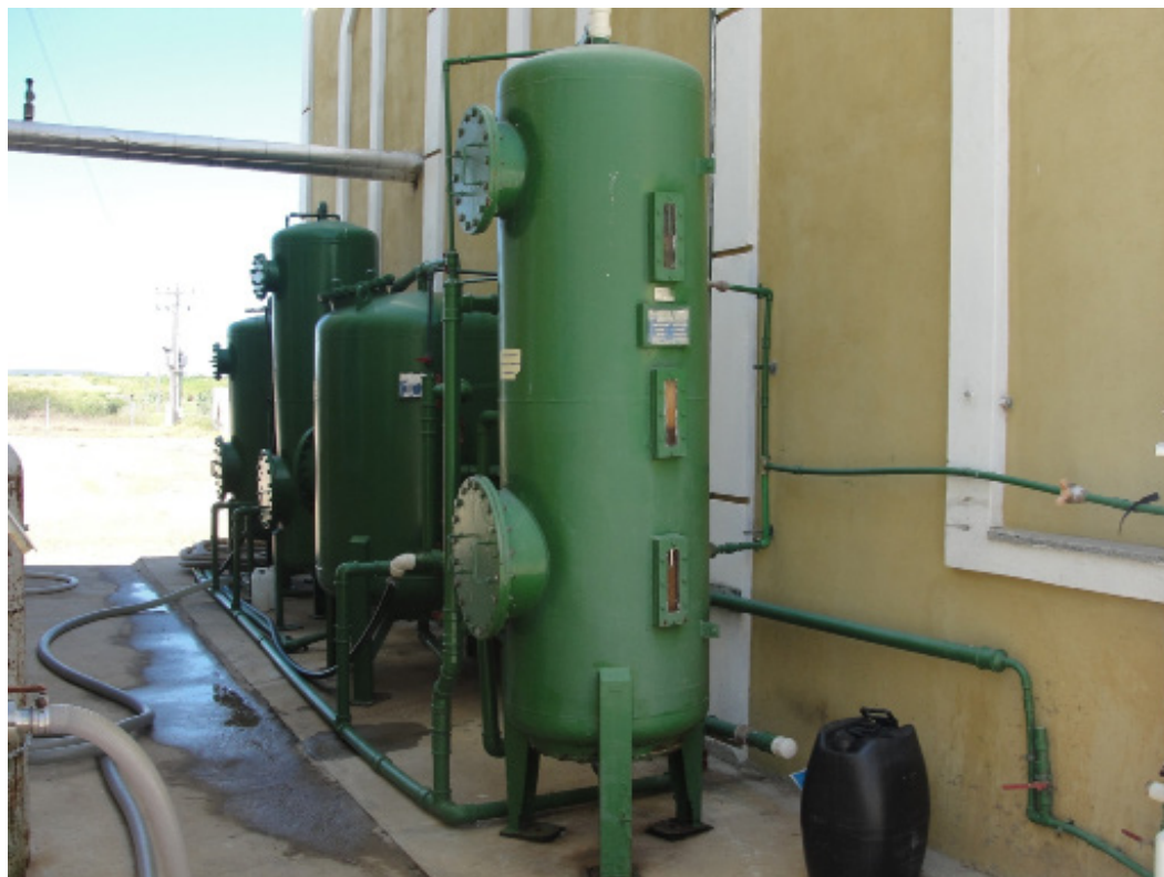
Figura 6. Exemplo de instalação para tratamento de água.
