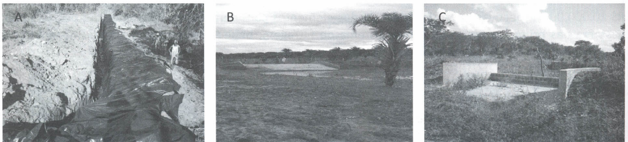
Figura 6. Vala impermeabilizada com lona plástica (A); barragem construída em linhas de drenagem com sangradouro (B); barragem subterrânea em funcionamento com seus principais elementos (C).
