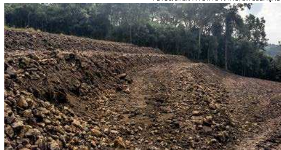
Figura 2c - Área pronta para a implantação do vinhedo com confeção de terraços para controle de erosão
