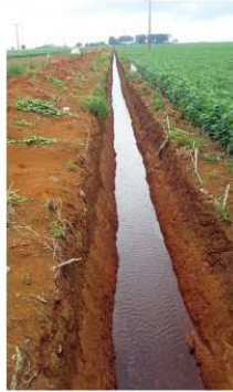
Figura 2. Construção de drenos com o objetivo de auxiliar no escoamento do excesso de água resultante do volume de chuvas.
