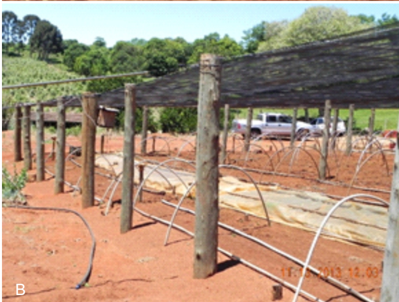
Figura 10. Cobertura e sombreamento de viveiro de mudas de erva-mate: A) Amambai, MS, 2014; B) Machadinho, RS, 2013
