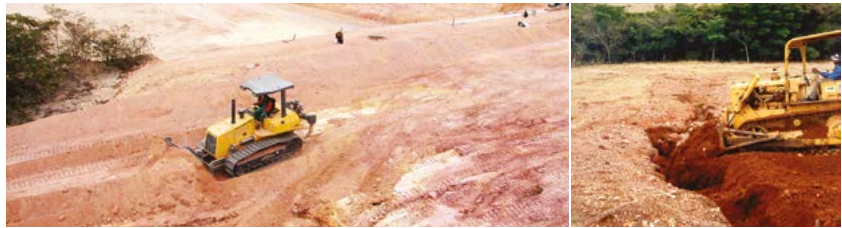
Figuras 6.69 e 6.70 – Detalhes da sistematização do terreno eliminando os sulcos no solo.
