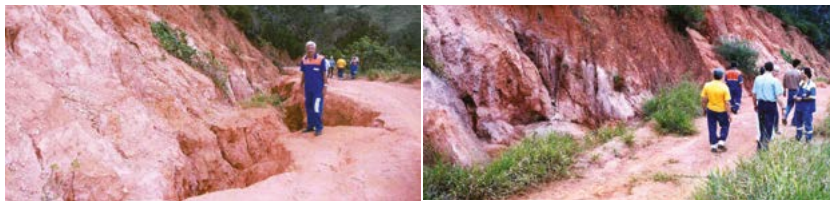
Figuras 6.88 e 6.89 – Detalhes da erosão em estrada rural ocasionada pela drenagem superficial deficiente.
