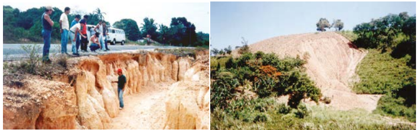
Figuras 6.29 e 6.30 – Detalhes da degradação ambiental causada pela erosão – voçoroca na margem de uma estrada (esq.) e erosão laminar com deslizamento em uma área recém-preparada para plantio (dir.).
