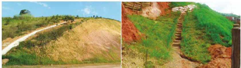
Figuras 6.85 e 6.86 – Canaleta de cimento (esq.) e de bambu (dir.) para desviar a água em taludes.
