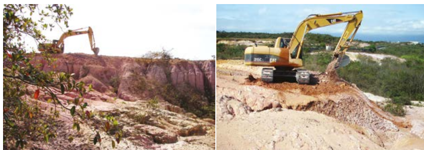
Figuras 6.109 e 6.110 – Detalhes da suavização das paredes da voçoroca.
