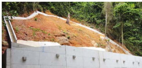
Figura 6.87 – Canaleta na parte de cima do talude de contenção e escada de dissipação de cimento nas laterais para desviar e conduzir a água da chuva e reduzir sua velocidade.
